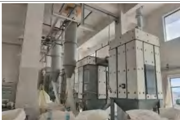
1#干粉灭火剂进料废气处理设施
