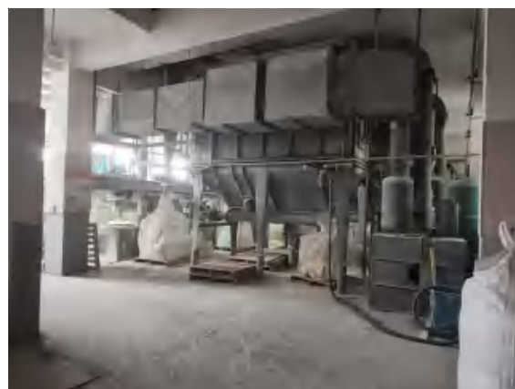
1#、2#干粉灭火剂粉碎、筛分、灌装废气处理设施
