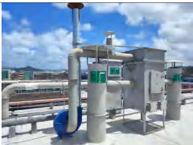
2#干粉灭火剂混合、干燥废气处理设施
