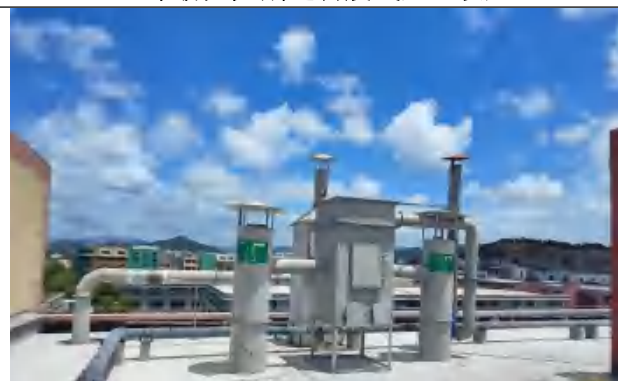
1#干粉灭火剂混合、干燥废气处理设施
