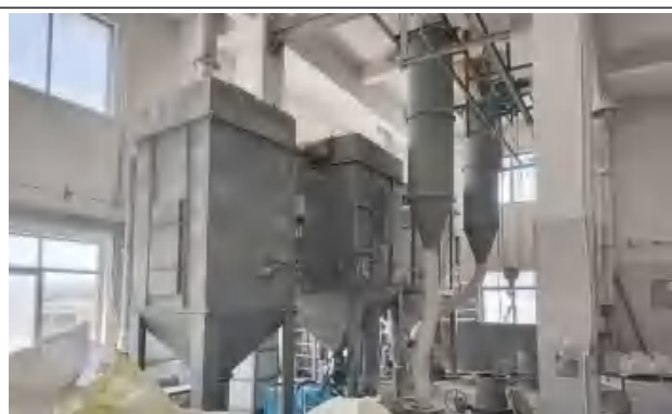
3#干粉灭火剂进料废气处理设施
