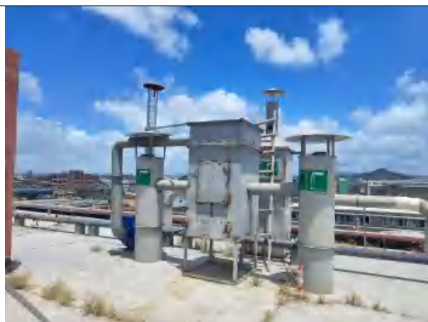
3#干粉灭火剂混合、干燥废气处理设施
