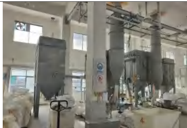
2#干粉灭火剂进料废气处理设施
