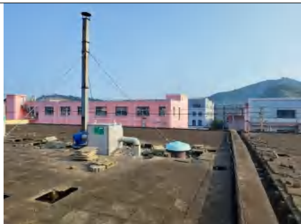
烘道废气处理设施
