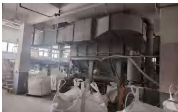
3#、4#干粉灭火剂粉碎、筛分、灌装废气处理设施
